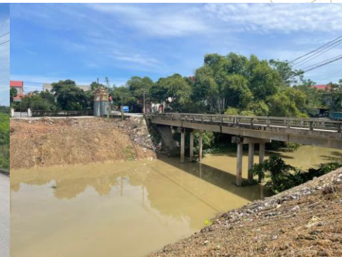
Hiện trạng giao thông, thoát nước mặt kênh Tiêu Thủy
