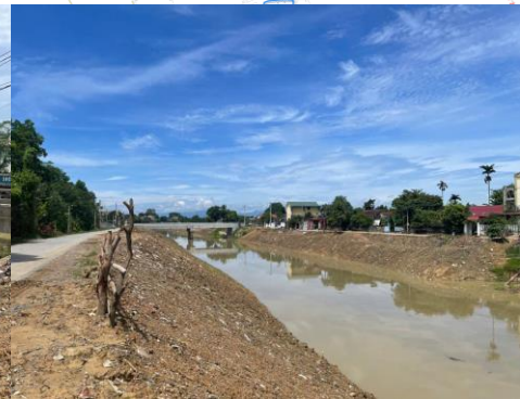
Hiện trạng giao thông, thoát nước mặt kênh Tiêu Thủy
